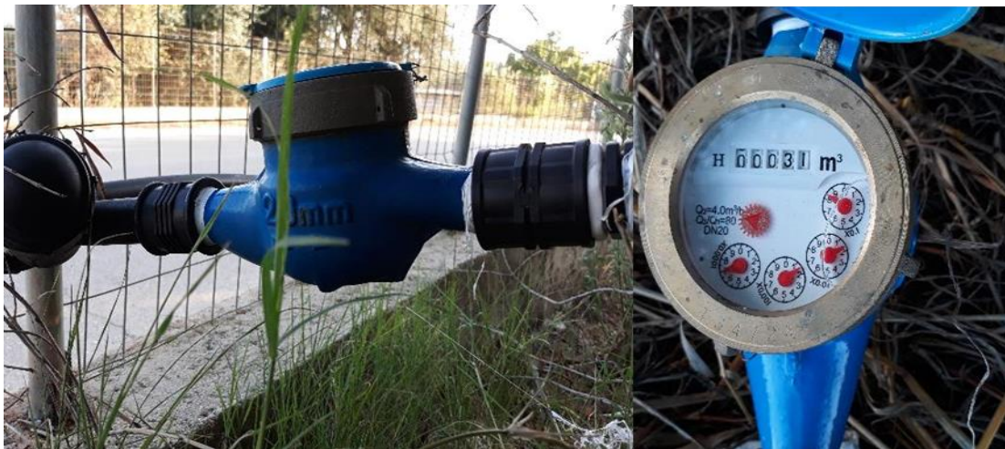
Εικόνα 16 Υδρόμετρο εγκατεστημένο στη δευτερεύουσα γραμμή άρδευσης του πιλοτικού αγροτεμαχίου
